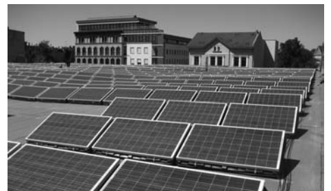
EVH-Solaranlage auf dem Dach des Wohncenters Lührmann
